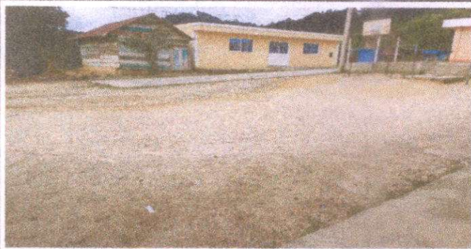
Foto 5: Patio en mal estado a trabajar
