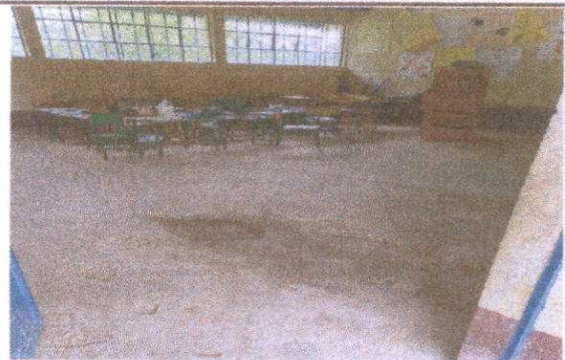
Foto 4: Piso en mal estado
