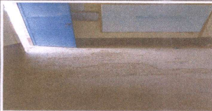
Foto 3 . Estado actual del piso del aula
